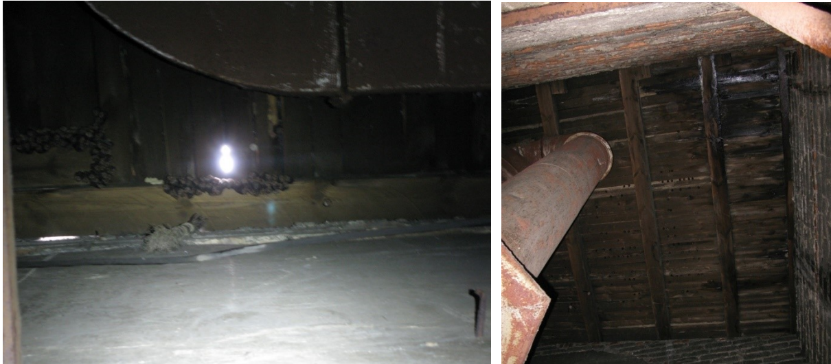
Zdj. 1 i 2: Stan poszycia dachu siedliska kolonii podkowca małego w Sławniowicach.
